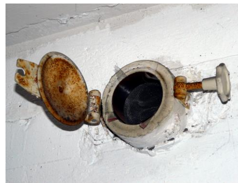
Entlüftungsöffnung mit geöffnetem Verschluss.
